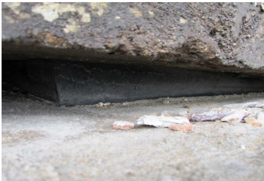
Foto 18: Vista do bloco de fundação do apoio 02 – aproximação observação do aparelho de apoio esmagado sob a viga VL04.
