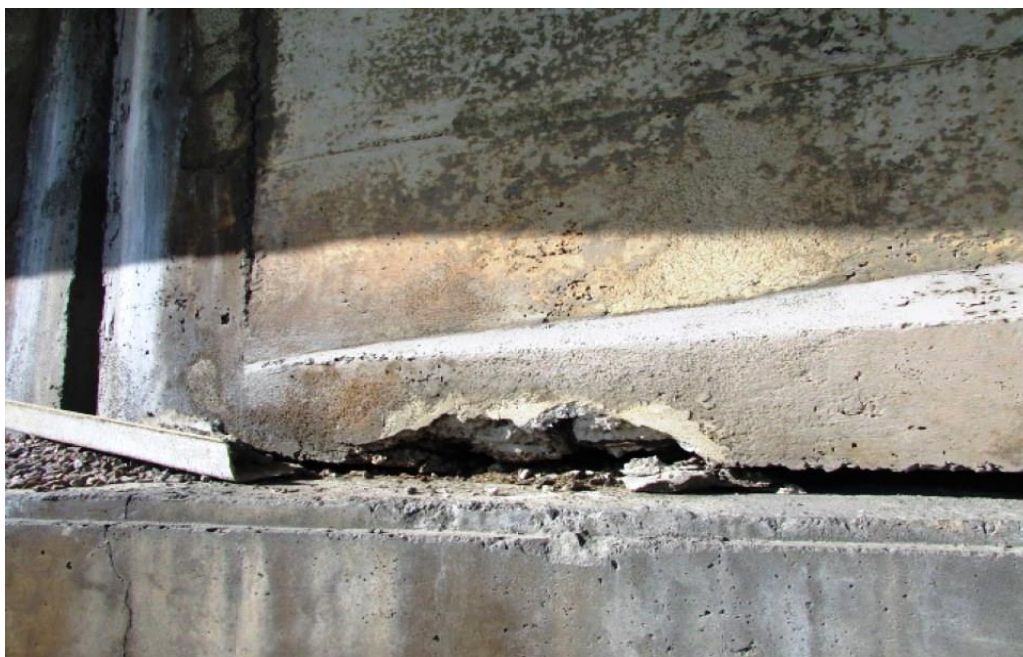
Foto 103: Face lateral longarina VL04 – trecho de disgregação do concreto com armaduras expostas e oxidadas na, inclusive com perda de seção na extremidade da mesa inferior da viga longarina VL.04, sobre a projeção da linha de apoio 07
