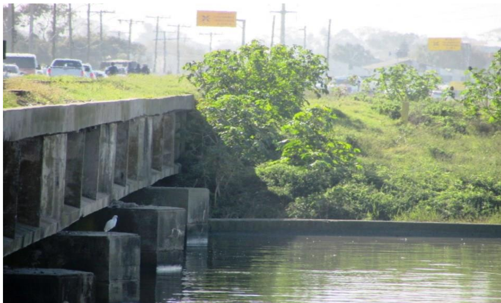
Foto 122: Vista do maciço de solo lateral ao lado Oeste da OAE, no encontro Sul da OAE, protegido por vegetação superficial.
