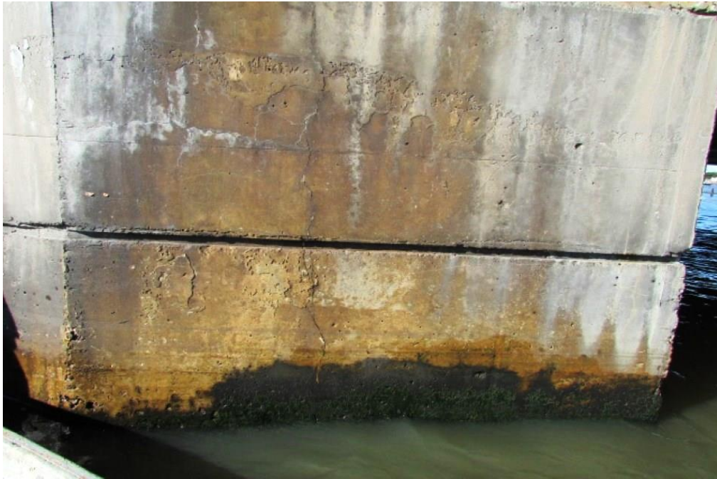
Foto 36: Vista do bloco de fundação do apoio 07 – Trincas com aberturas de 0,2 a 1,0mm.
