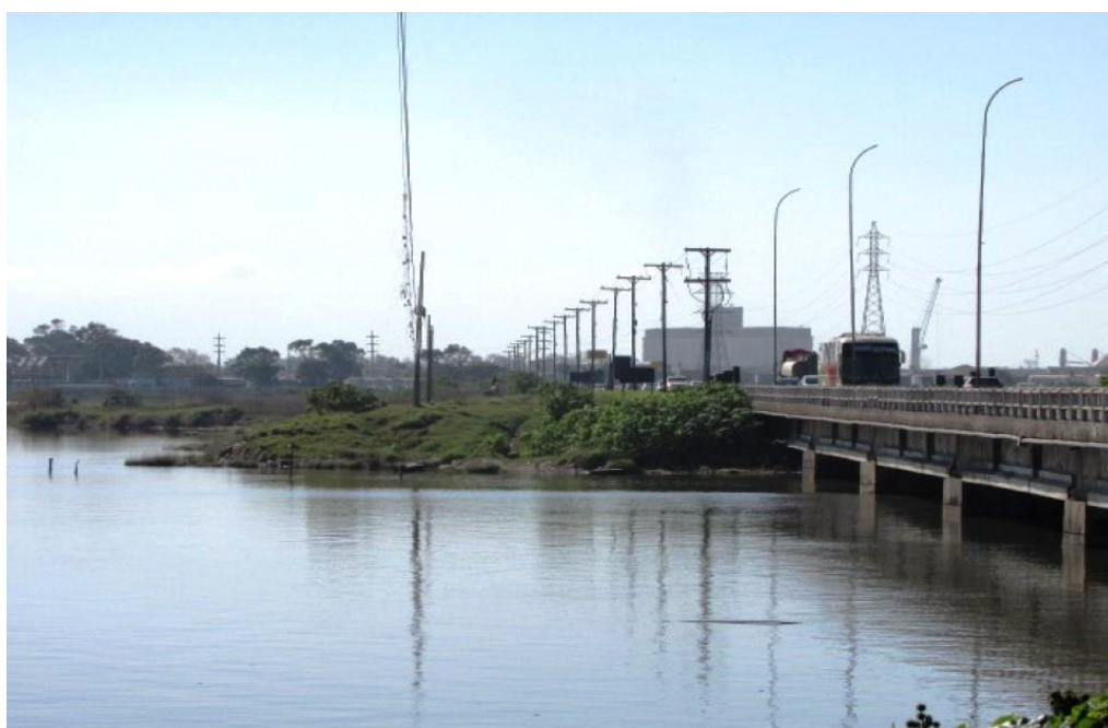
Foto 123: Vista do maciço de solo lateral ao lado Leste da OAE, no encontro Sul da OAE, protegido por vegetação superficial..
