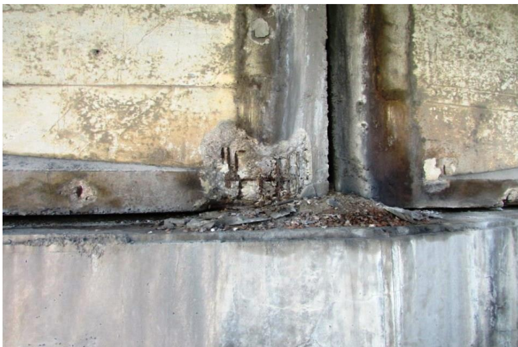
Foto 84: Face lateral longarina VL01 – trecho com exposição de armaduras oxidadas, inclusive com perda de seção na extremidade da mesa inferior da viga longarina VL.01, sobre a projeção da linha de apoio 06
