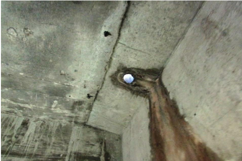
Foto 80: Vão 08 – drenos de drenagem rompido entre as vigas longarinas VL.01 e VL.02
