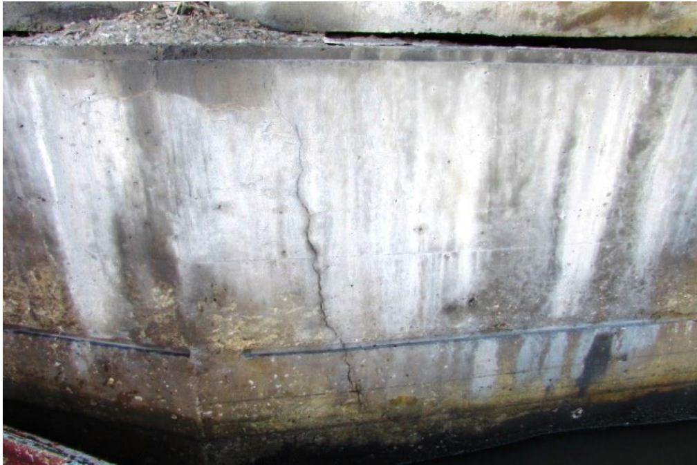
Foto 22: Vista do bloco de fundação do apoio 04 – trinca com abertura de 1,0mm
