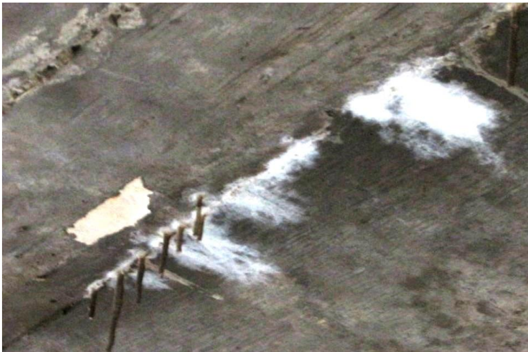
Foto 64: Vão 04 – Aproximação da foto anterior.
