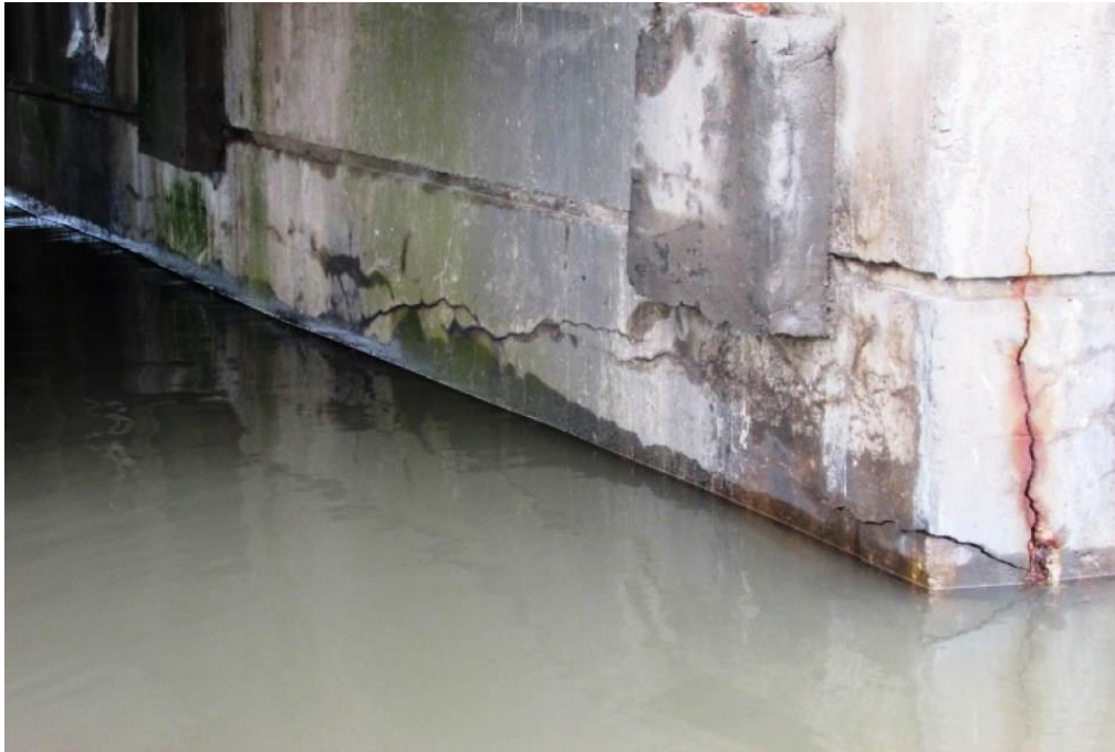
Foto 10: Vista do bloco de fundação do apoio 02 – trincas com aberturas que variam de 0,3 a 2,0mm
