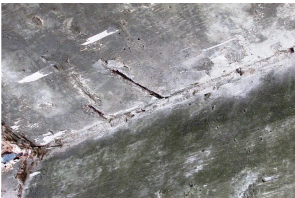
Foto 66: Vão 04 – Aproximação da foto anterior.
