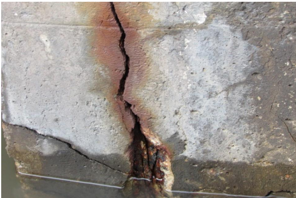
Foto 11: Vista do bloco de fundação do apoio 02 – aproximação de uma trinca com abertura de 2,0mm
