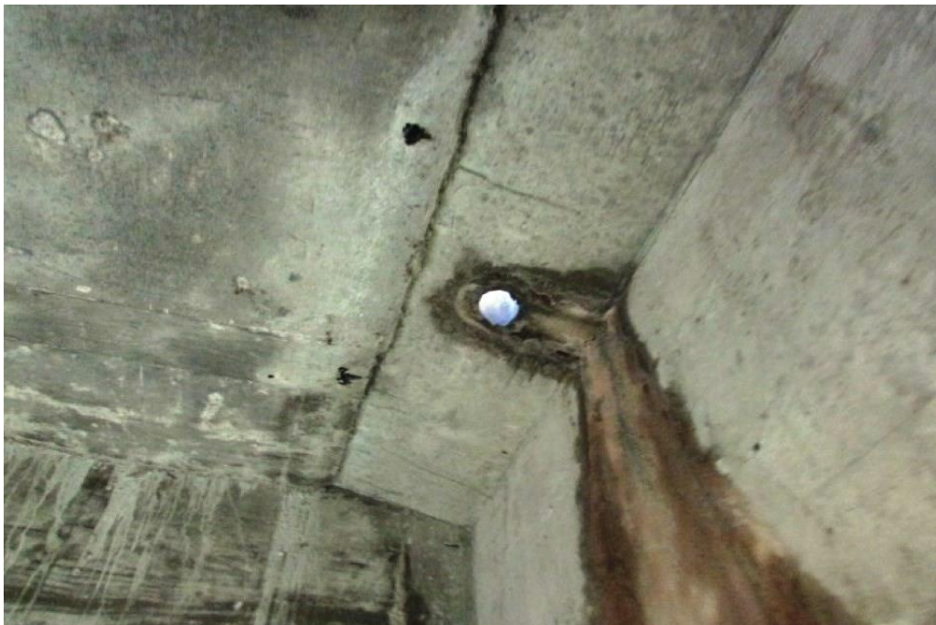
Foto 149: dreno de drenagem rompido entre as vigas longarinas VL.01 e VL.02, vão 08
