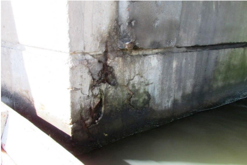
Foto 40: Vista do bloco de fundação do apoio 08 – Neste ponto é possível observar disgregação do concreto com armadura exposta e oxidadas.
