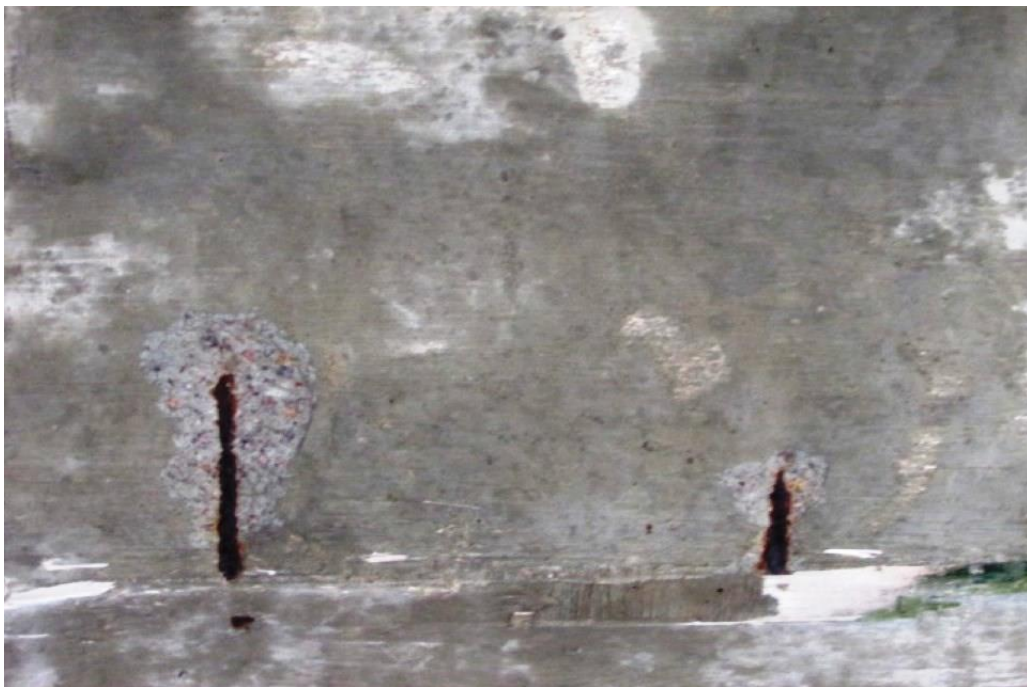
Foto 61: Vão 03 – Aproximação da foto anterior.
