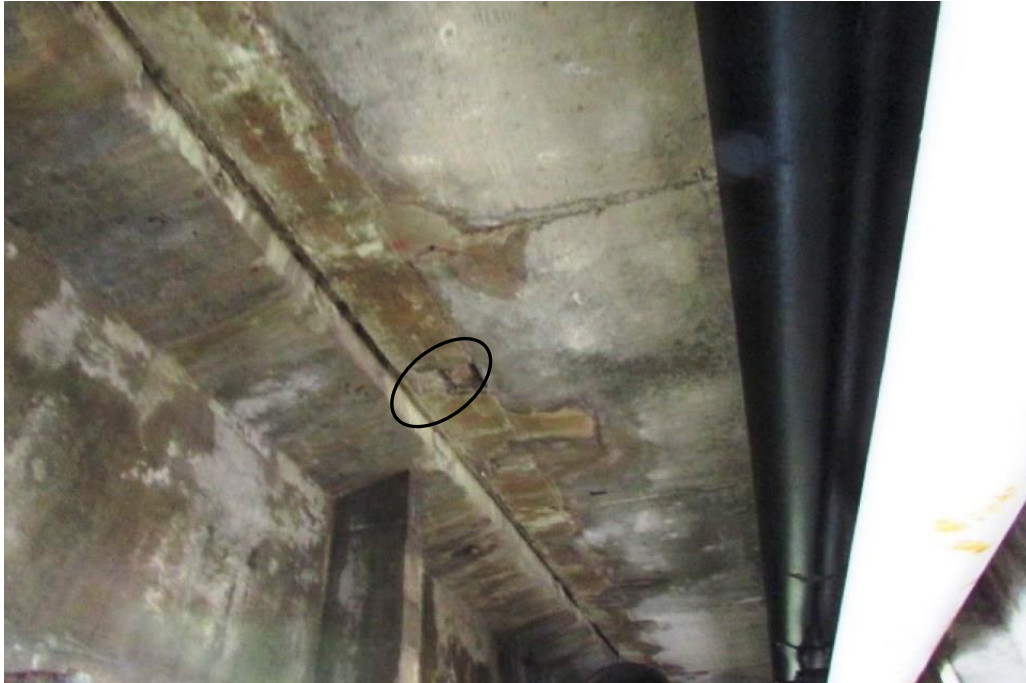
Foto 53: Vão 02 – disgregação do concreto com armadura expostas e oxidada na laje lateral em balanço do lado Oeste da OAE.
