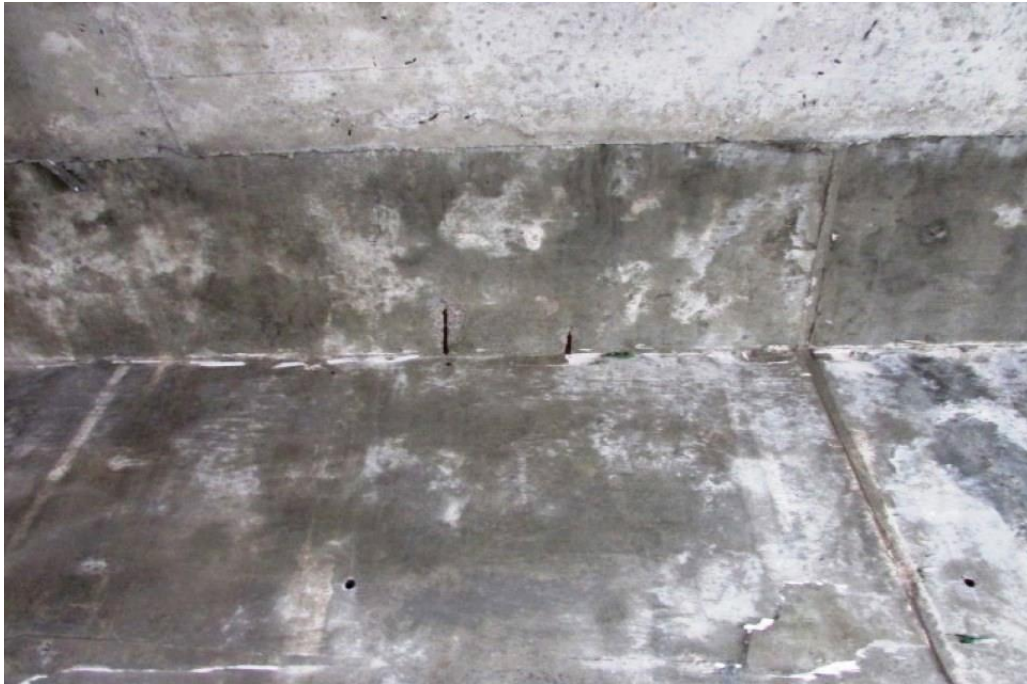
Foto 60: Vão 03 – armaduras expostas e oxidadas na mesa superior da viga longitudinal VL.03.
