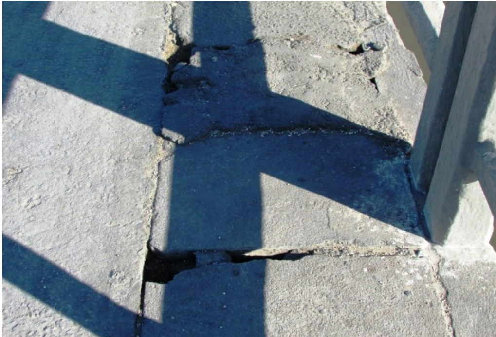
Foto 148: ruptura das placas de fechamento junto ao passeio de pedestres
