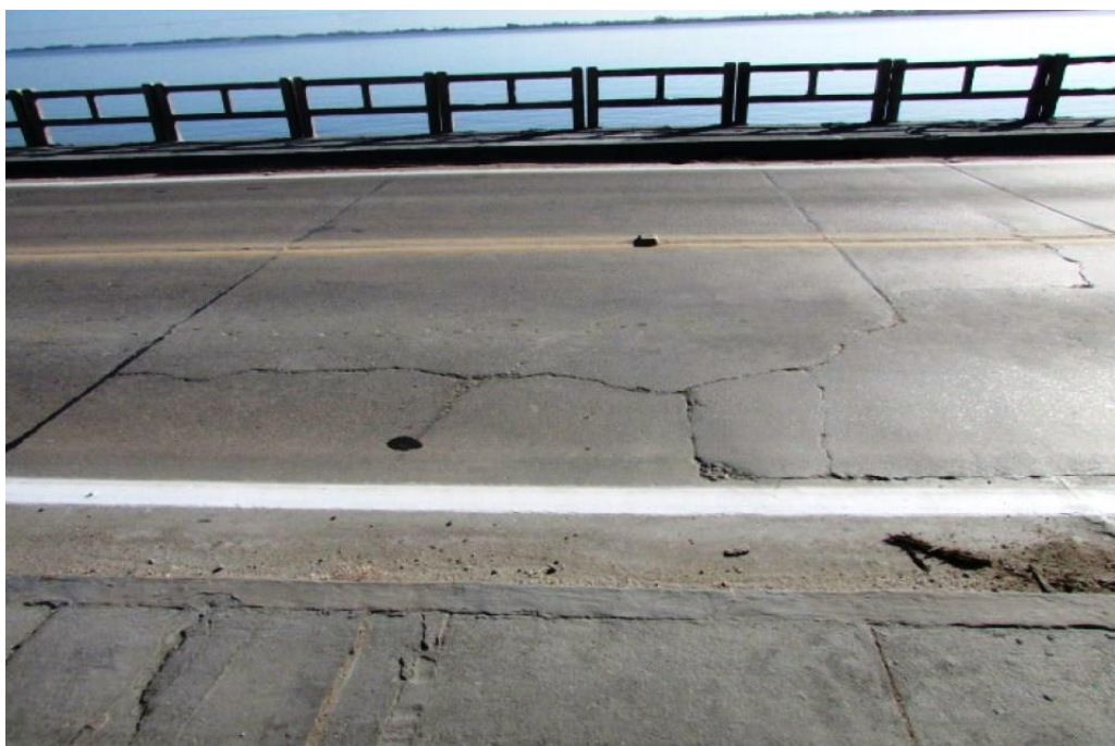
Foto 133: trincas no pavimento rígido da via sobre a obra, vão 04.
