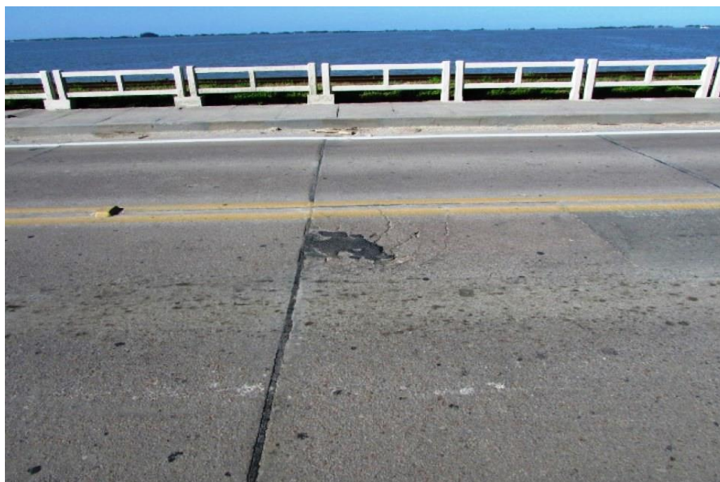
Foto 127: trecho com reparo mal executado junto ao pavimento rígido da via sobre a OAE, além de trecho de disgregação da placa de concreto, vão 01.
