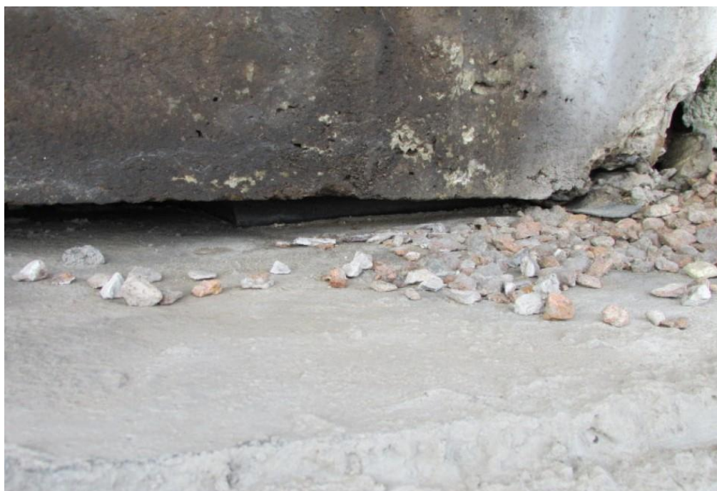
Foto 17: Vista do bloco de fundação do apoio 02 – observação do aparelho de apoio esmagado sob a viga VL04.
