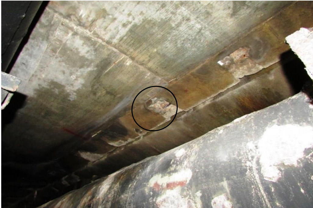
Foto 70: Vão 05 – ponto de disgregação do concreto com armadura exposta e oxidada na laje lateral em balanço do lado Oeste da OAE.
