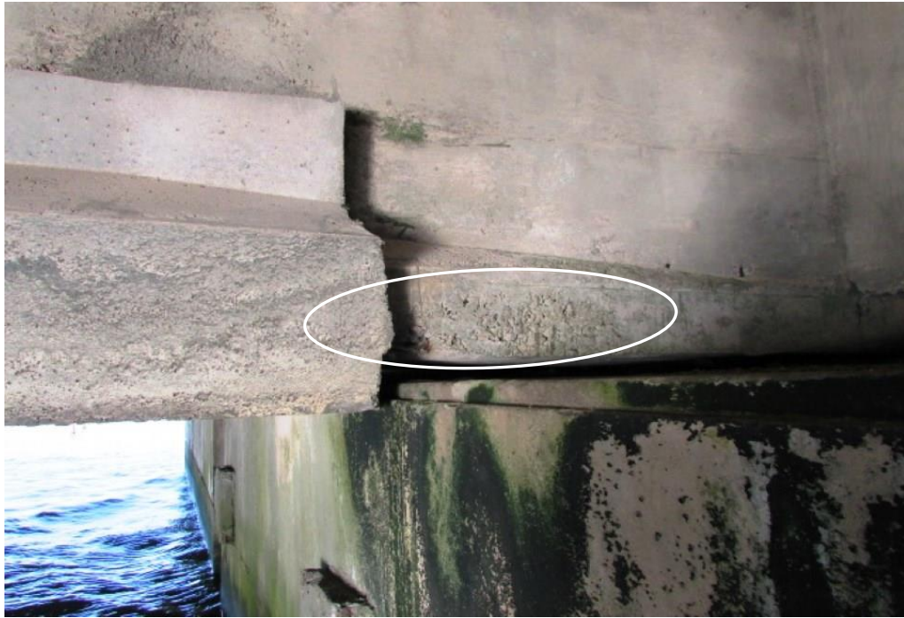
Foto 88: Face lateral longarina VL02 – trecho de segregação do concreto com exposição de armaduras oxidadas na extremidade da mesa inferior da viga longarina VL.02, sobre a projeção da linha de apoio 08
