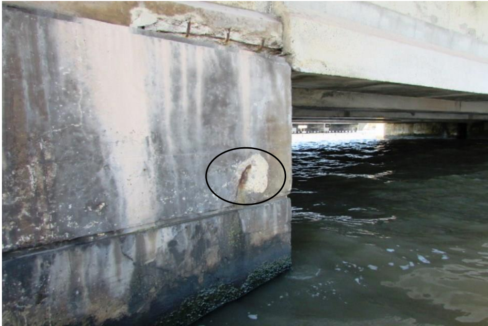
Foto 26: Vista do bloco de fundação do apoio 05 – Neste ponto é possível observar disgregação do concreto com armadura exposta.
