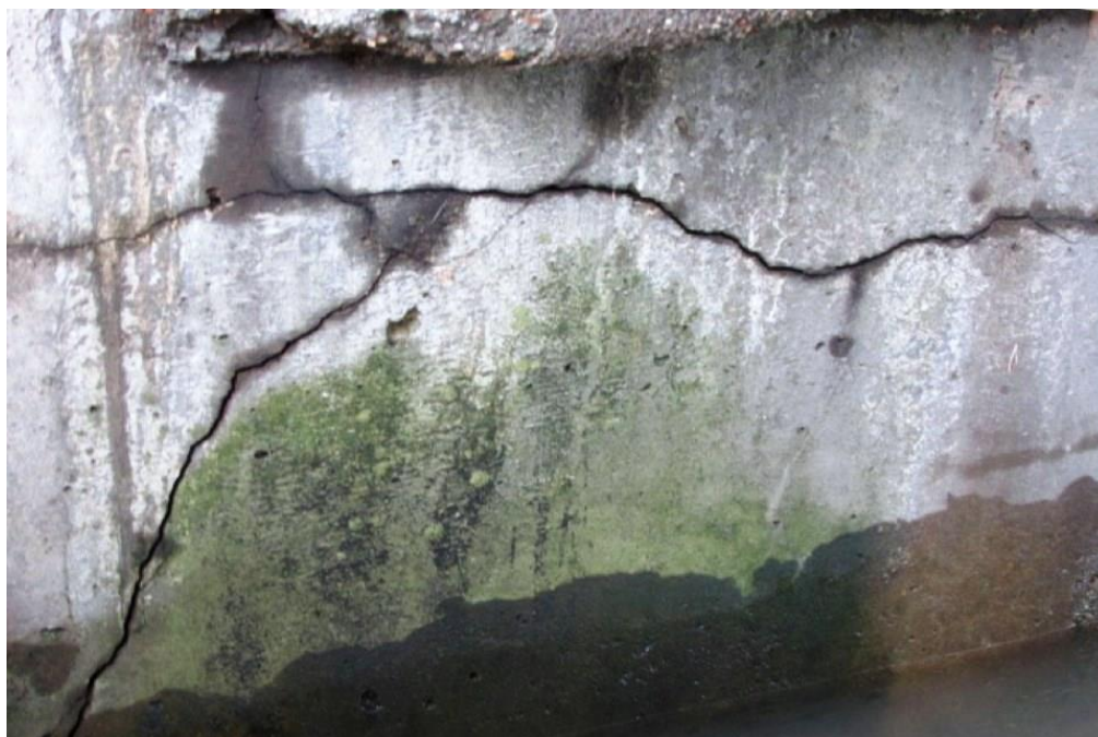
Foto 16: Vista do bloco de fundação do apoio 02 – aproximação de trincas com abertura de 1,0 mm na face Norte
