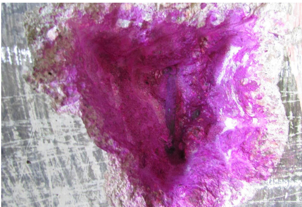
Foto 116: Face lateral longarina VL04 – ensaio de carbonatação (solução de fenolftaleína). Viga Longarina VL.4 – Encontro Norte – Face Leste.
