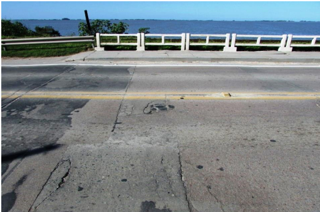
Foto 129: trecho de disgregação e reparo mal executado no pavimento rígido da via sobre a OAE, vão 01.
