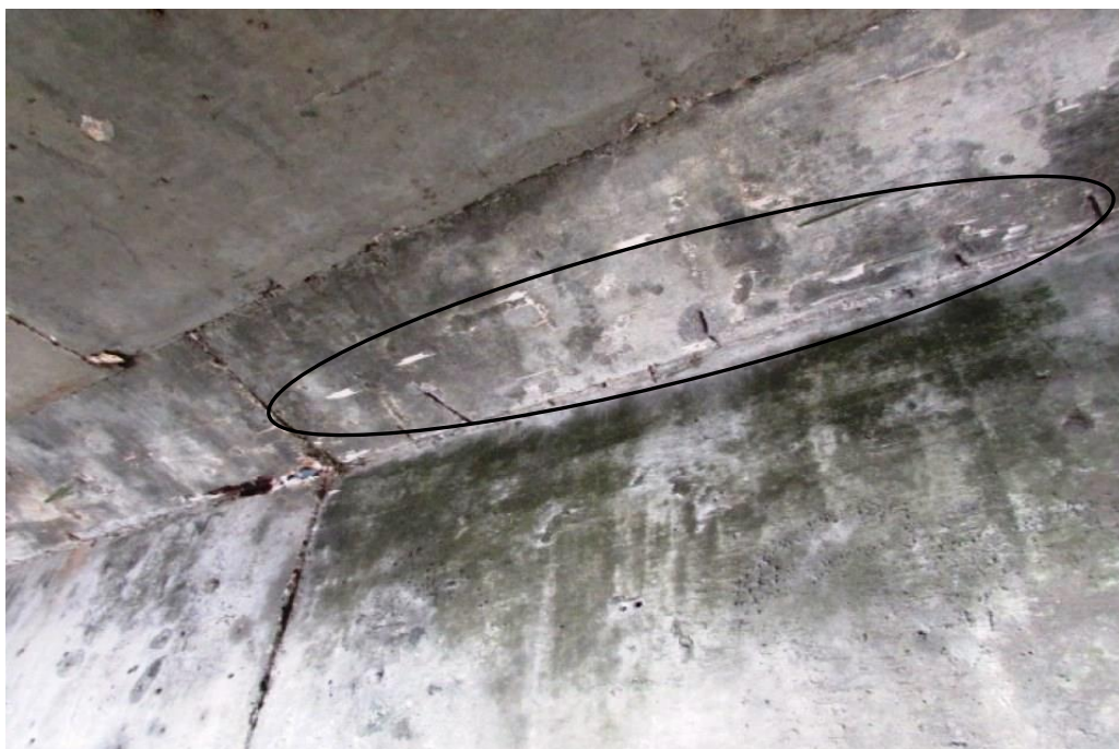
Foto 65: Vão 04 – pontos com armaduras expostas e oxidadas na mesa superior da viga longitudinal VL.03.
