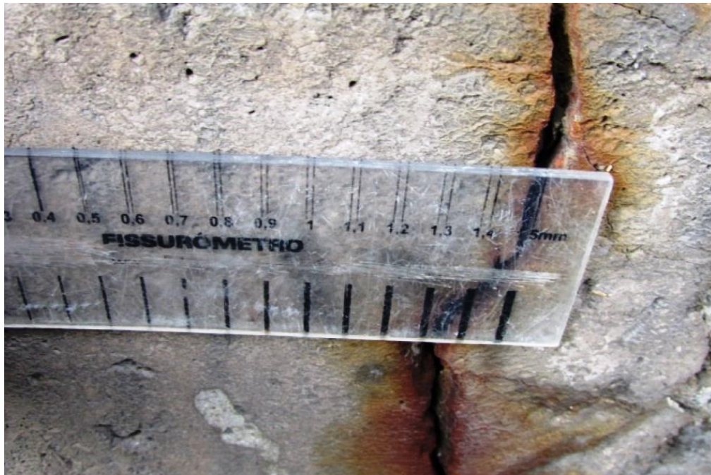
Foto 12: Vista do bloco de fundação do apoio 02 – aproximação de uma trinca com abertura de 2,0mm
