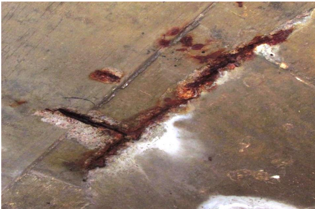
Foto 56: Vão 02 - Aproximação da foto anterior.
