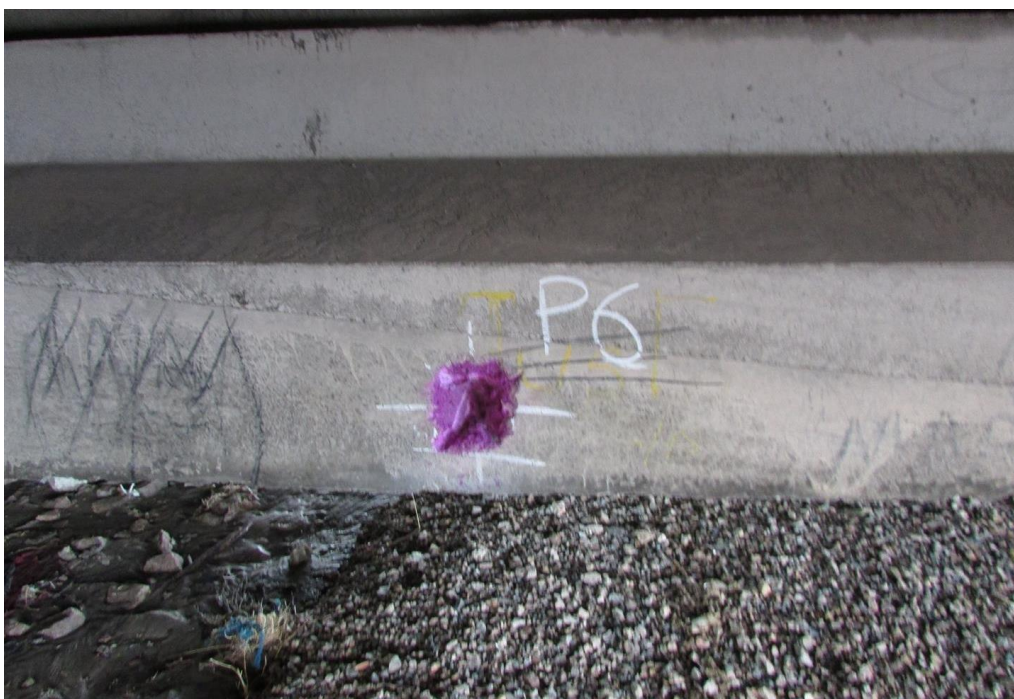
Foto 95: Face lateral longarina VL03 – ensaio de carbonatação (solução de fenolftaleína). Viga Longarina VL.3 – Trecho de Reforço – Face Leste.
