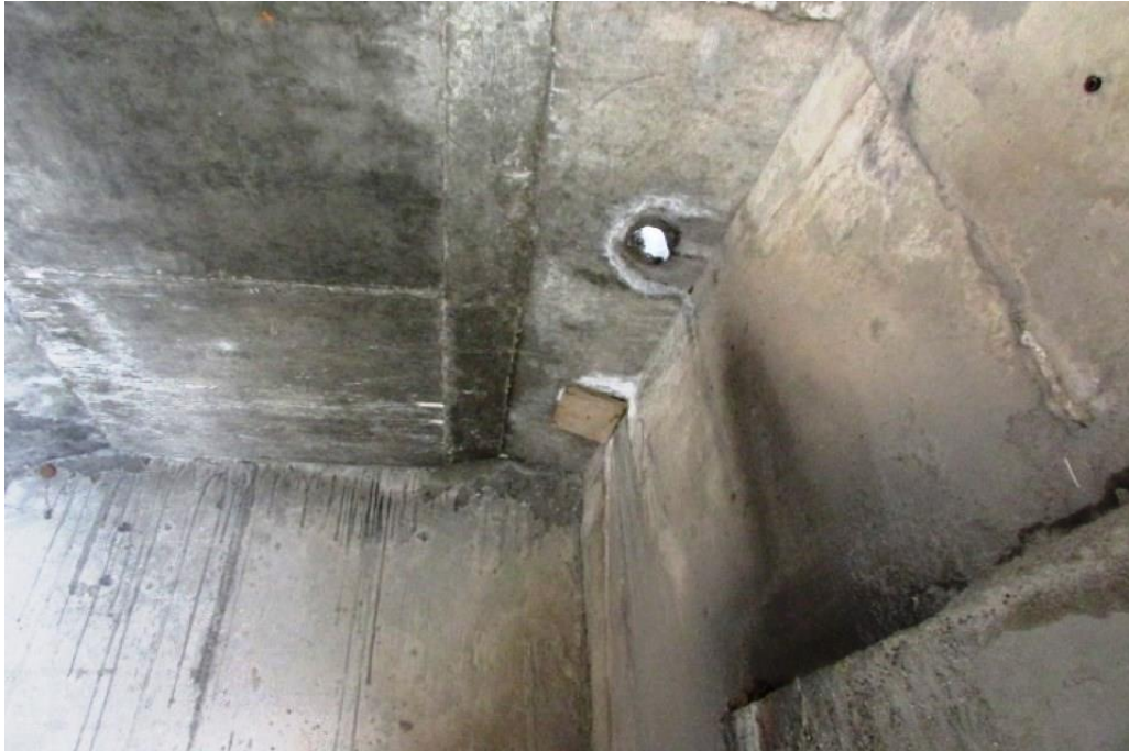
Foto 50: Vão 01 - forma remanescente junto à mesa superior da viga longarina VL.04, adjacente à linha de apoio 02.
