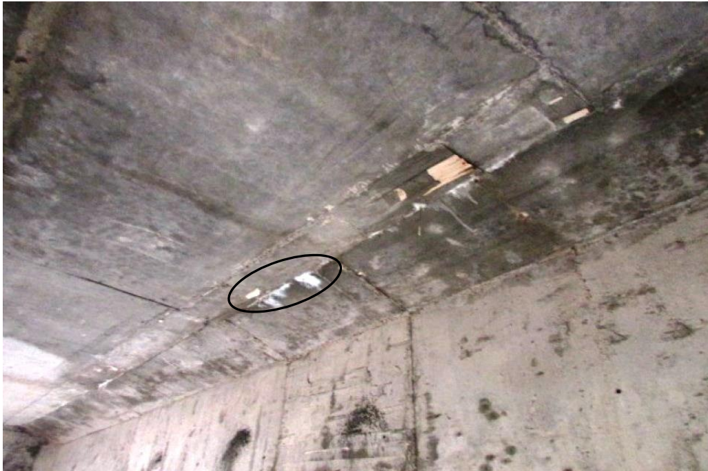
Foto 63: Vão 04 – fissura colmatada por eflorescência, inclusive com formação de estalactite na placa de pré-laje do tabuleiro, na interface com a mesa superior da viga longarina VL.02.
