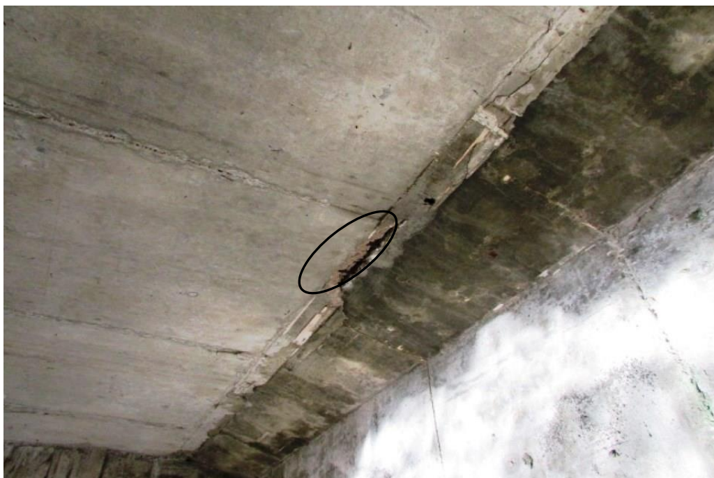
Foto 68: Vão 05 – trecho com exposição de armaduras oxidadas na placa de pré-laje do tabuleiro, na interface com a mesa superior da viga longarina VL.02.
