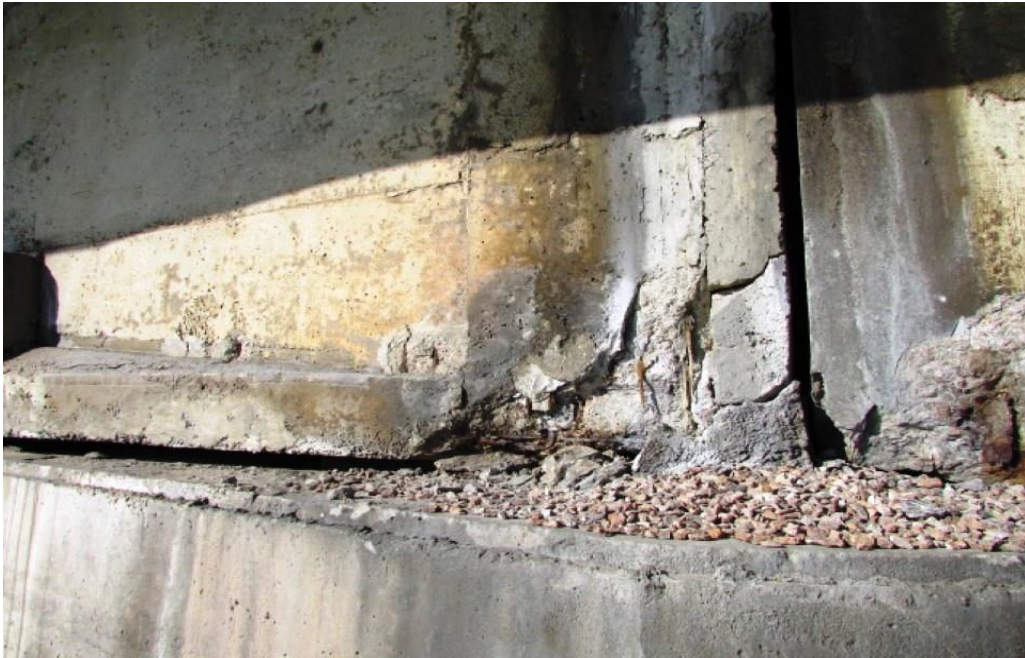
Foto 105: Face lateral longarina VL04 – disgregação do concreto com armaduras expostas e oxidadas na, inclusive com perda de seção na extremidade da mesa inferior da viga longarina VL.04, sobre a projeção da linha de apoio 08
