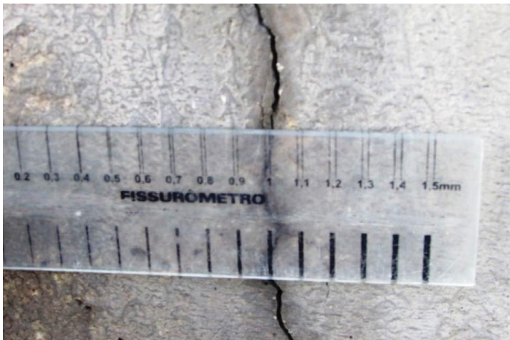
Foto 23: Vista do bloco de fundação do apoio 04 – aproximação trinca com abertura de 1,0mm
