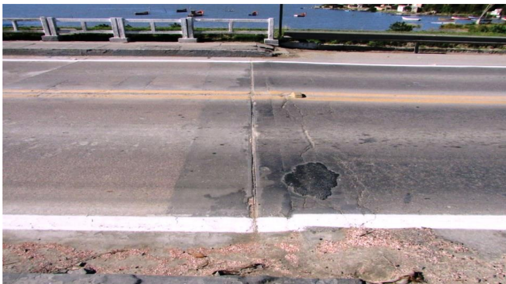
Foto 144: junta de dilatação locada sobre a projeção da linha de apoio 09, encontro Norte.
