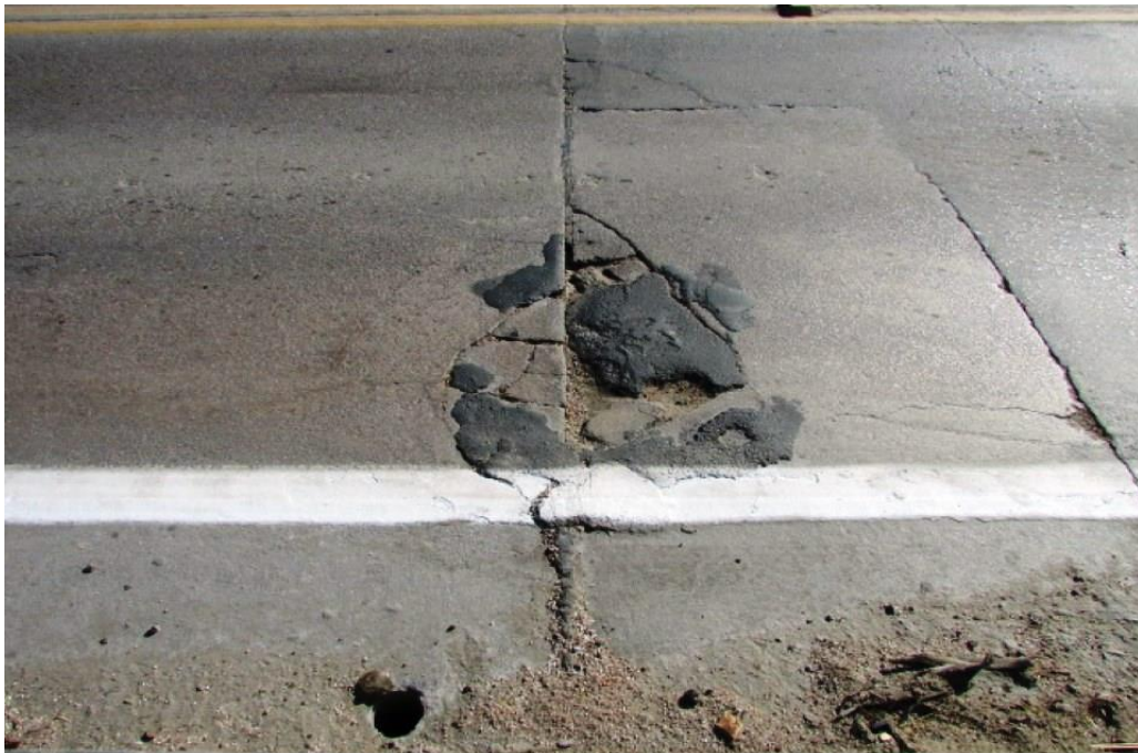
Foto 131: trecho rompido da placa de concreto do pavimento rígido da via sobre a obra, vão 03.
