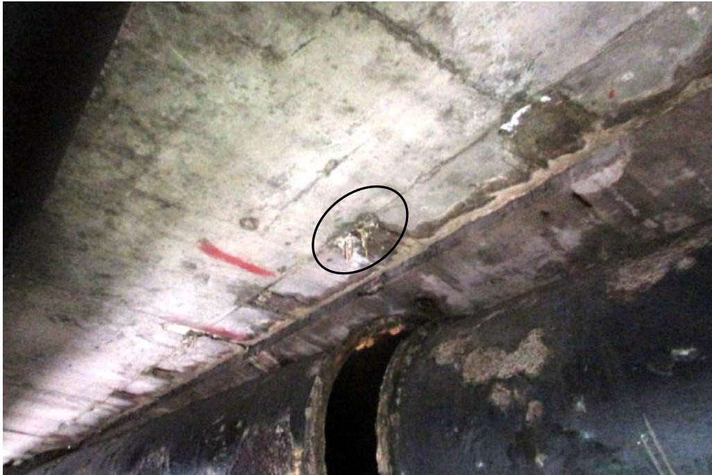
Foto 58: Vão 03 – fissura colmatada por eflorescência, inclusive com formação de estalactite na laje lateral em balanço do lado Oeste da OAE.
