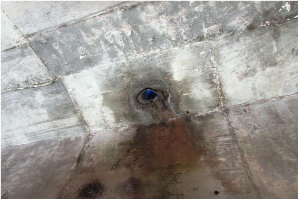
Foto 150: dreno em tubo de PVC curto, com diâmetro de 4”, posicionado entre as vigas longarinas VL.03 e VL.04, vão 06
