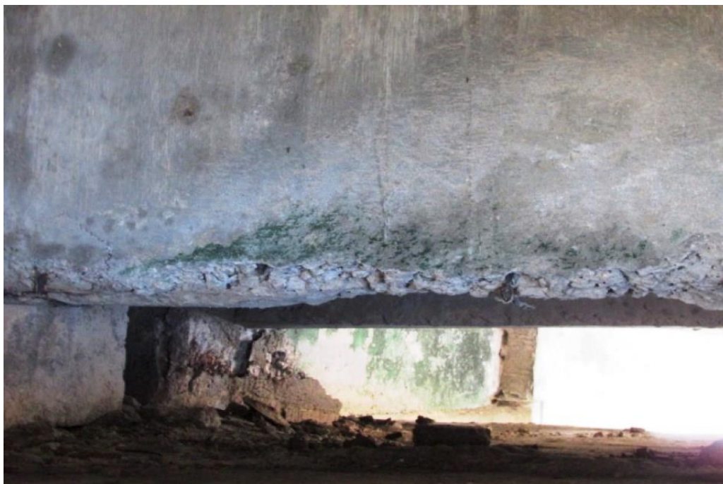
Foto 121: Face transversina VT24 – trecho de segregação do concreto com armaduras expostas e oxidadas na face Norte da viga transversina VT.24, locada sobre a projeção da linha de apoio 07.
