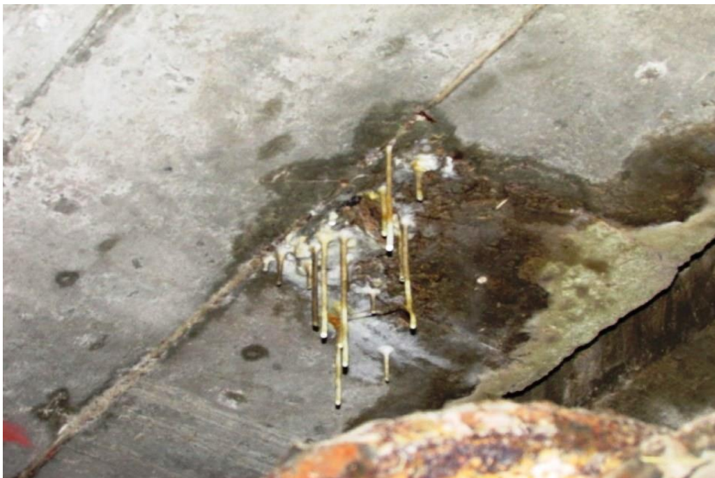
Foto 59: Vão 03 – Aproximação da foto anterior.
