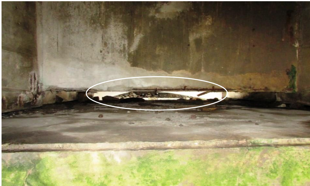
Foto 117: Face transversina VT04 – trecho de disgregação do concreto com armaduras expostas e oxidadas na face Norte da viga transversina VT.04, locada sobre a projeção da linha de apoio 02.
