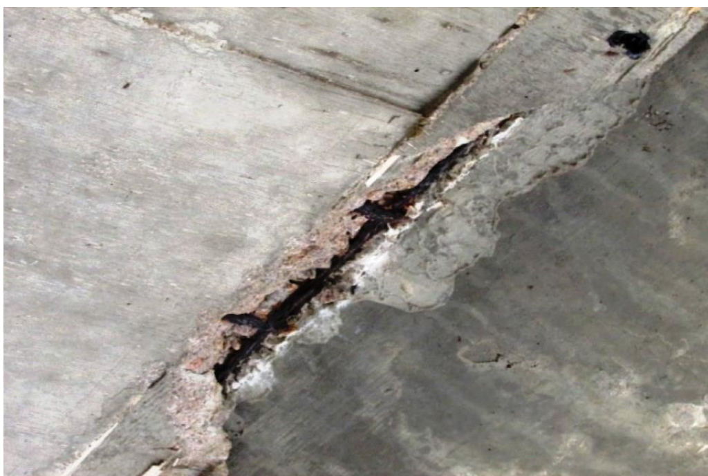
Foto 69: Vão 05 – Aproximação da foto anterior.
