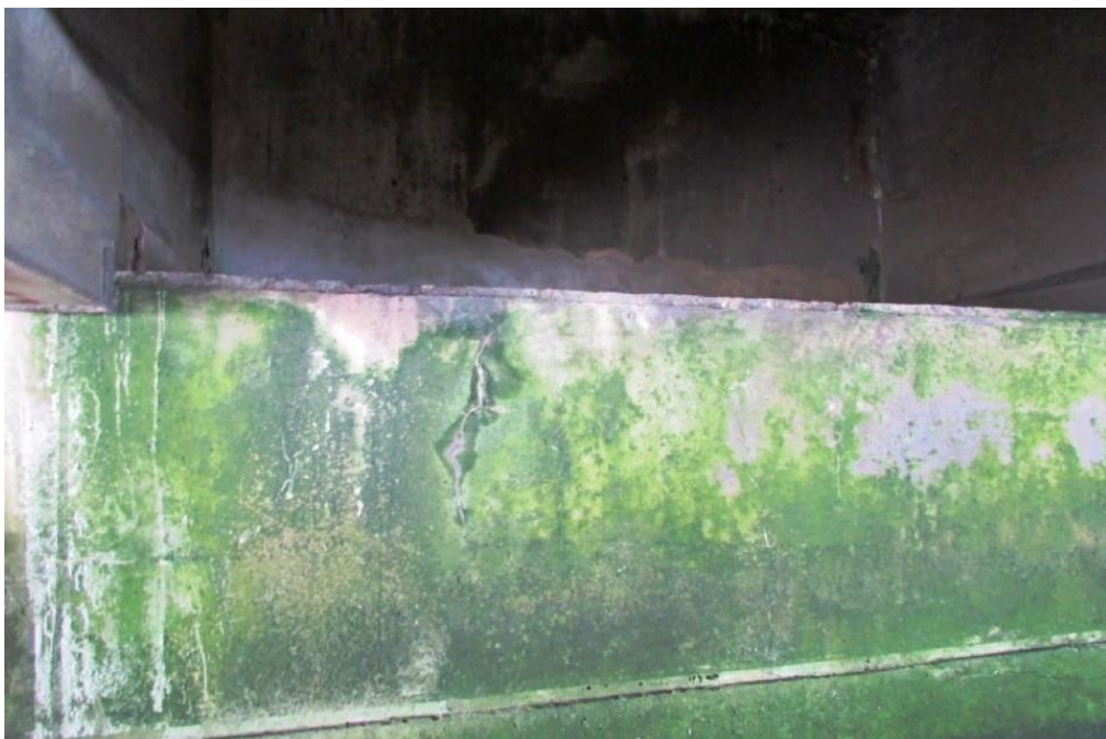
Foto 13: Vista do bloco de fundação do apoio 02 – fissuras colmatadas por eflorescência na face Norte.
