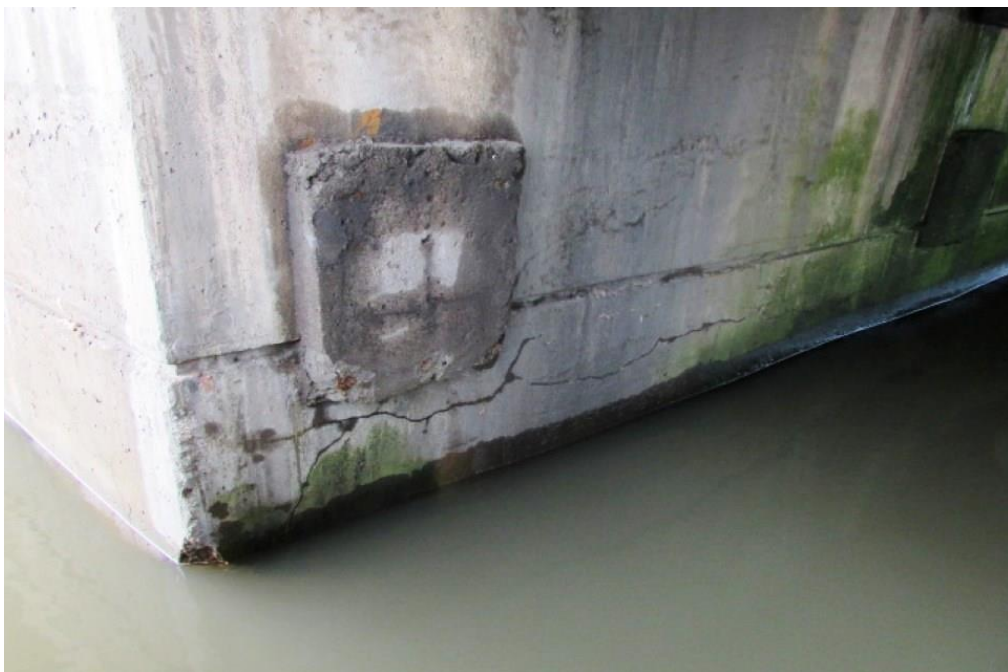
Foto 15: Vista do bloco de fundação do apoio 02 – trincas com abertura de 1,0 mm na face Norte
