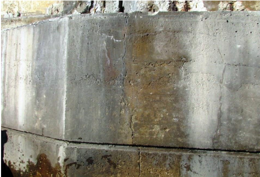
Foto 42: Vista do bloco de fundação do apoio 08 – Trincas com aberturas de 0,2 a 1,0mm.
