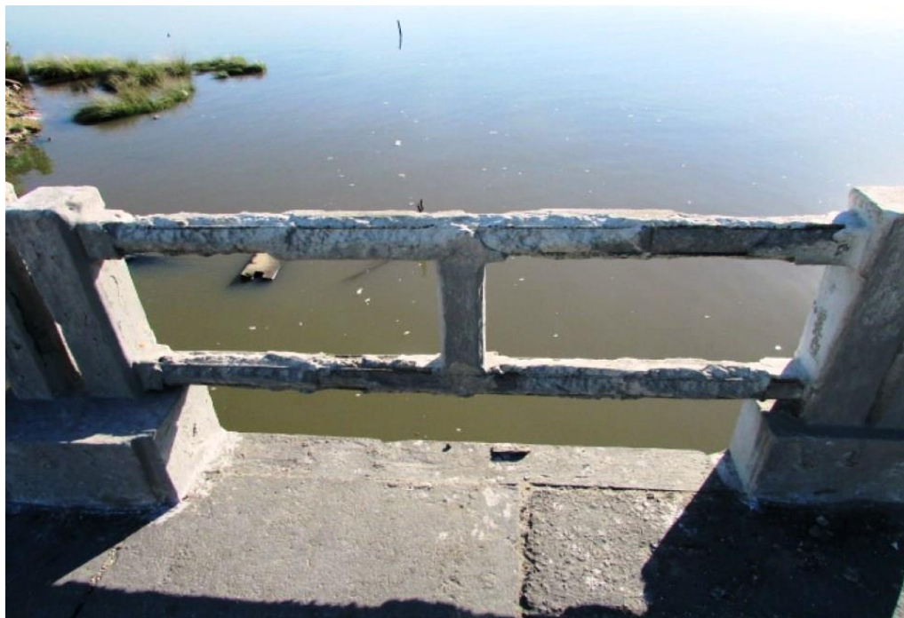
Foto 147: módulo do guarda-corpo totalmente degradado junto à lateral da pista de rodagem sobre a obra.
