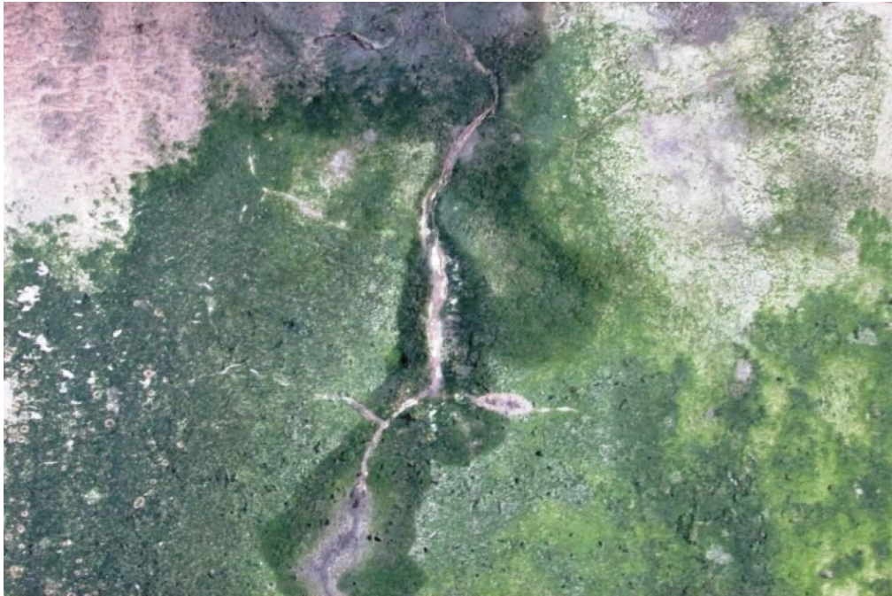
Foto 14: Vista do bloco de fundação do apoio 02 – aproximação fissuras colmatadas por eflorescência na face Norte.
