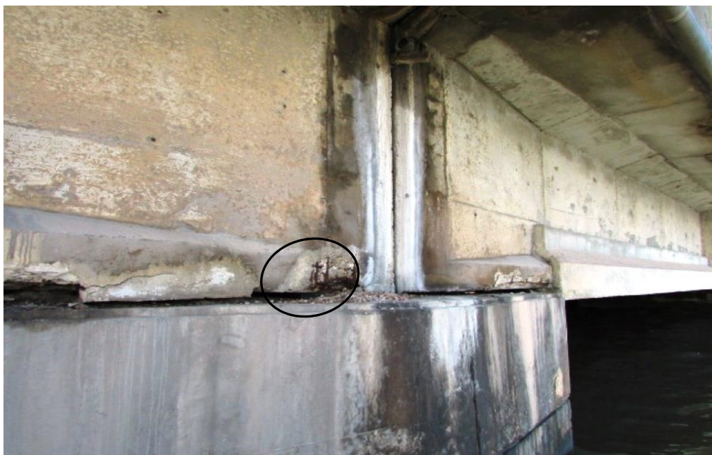
Foto 101: Face lateral longarina VL04 – disgregação do concreto com armaduras expostas e oxidadas na, inclusive com perda de seção na extremidade da mesa inferior da viga longarina VL.04, sobre a projeção da linha de apoio 05
