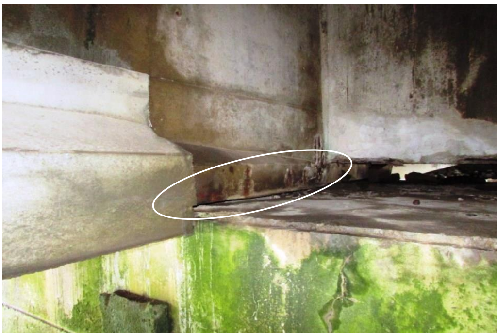
Foto 92: Face lateral longarina VL03 – trecho com exposição de armaduras oxidadas, inclusive com perda de seção na extremidade da mesa inferior da viga longarina VL.03, sobre a projeção da linha de apoio 02
