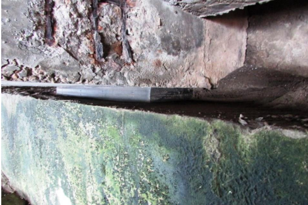
Foto 44: Vista do bloco de fundação do apoio 09 – Aparelho de apoio levemente esmagado sob a projeção da viga VL03
