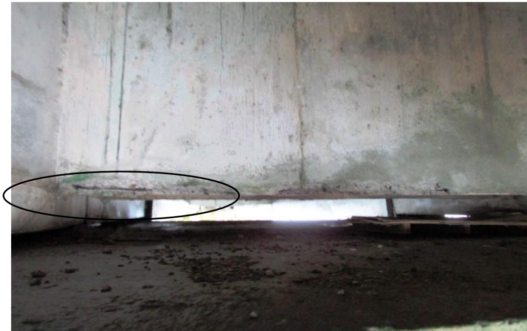
Foto 119: Face transversina VT08 – trecho de disgregação do concreto com armaduras expostas e oxidadas na face Sul da viga transversina VT.08, locada sobre a projeção da linha de apoio 03.
