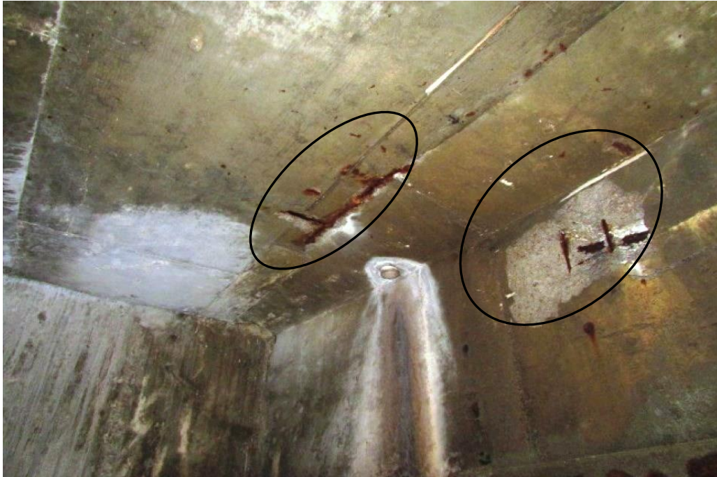
Foto 55: Vão 02 - Aproximação da foto anterior.
