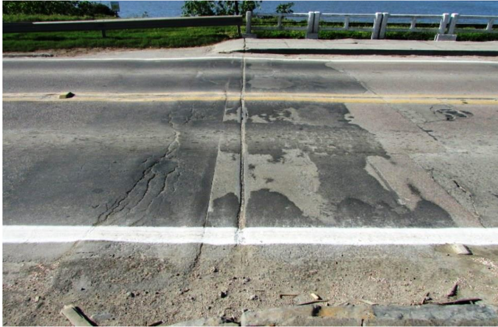
Foto 142: junta de dilatação locada sobre a projeção da linha de apoio 01, encontro Sul.
