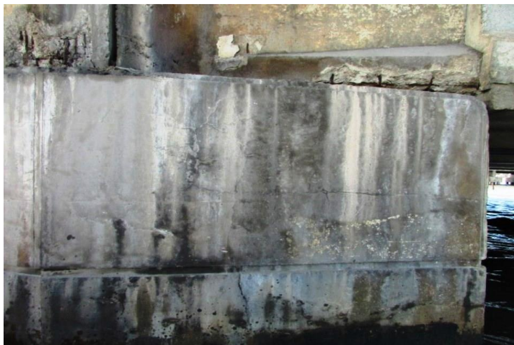
Foto 32: Vista do bloco de fundação do apoio 06 – Trincas com aberturas de 0,2 a 0,4mm.
