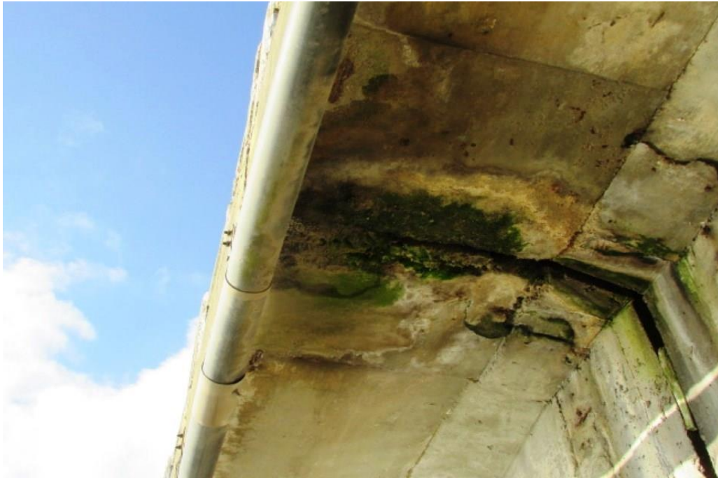
Foto 77: Vão 07 – manchas de escorrimento na laje lateral em balanço do lado Leste, na projeção da junta de dilatação locada sobre à linha de apoio 08.
