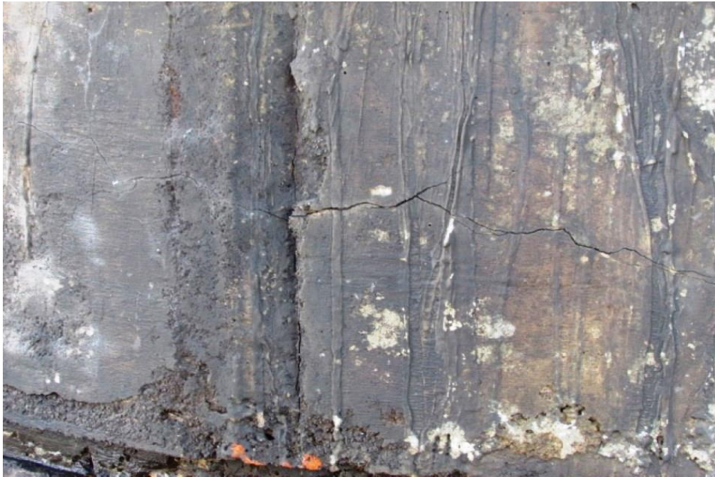
Foto 28: Vista do bloco de fundação do apoio 05 – Trinca com abertura de 0,4mm..
