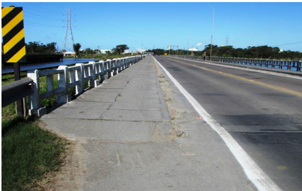
Foto 145: Vista do passeio de pedestres junto à lateral da pista de rodagem sobre a obra, lado Oeste da OAE, em visão da cabeceira do encontro Sul. Notar ausência de barreira rígidas de segurança, com a presença apenas de guarda-corpo em peças pré-moldadas de concreto na extremidade da superestrutura.
