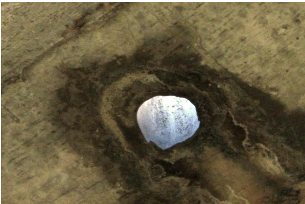
Foto 81: Vão 08 – Aproximação da foto anterior.
