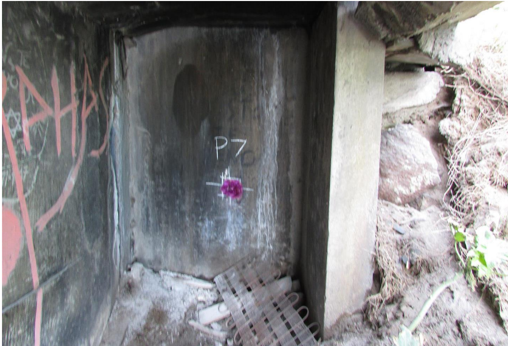
Foto 46: Vista do bloco de fundação do apoio 09 – ensaio de carbonatação na travessa – face leste
